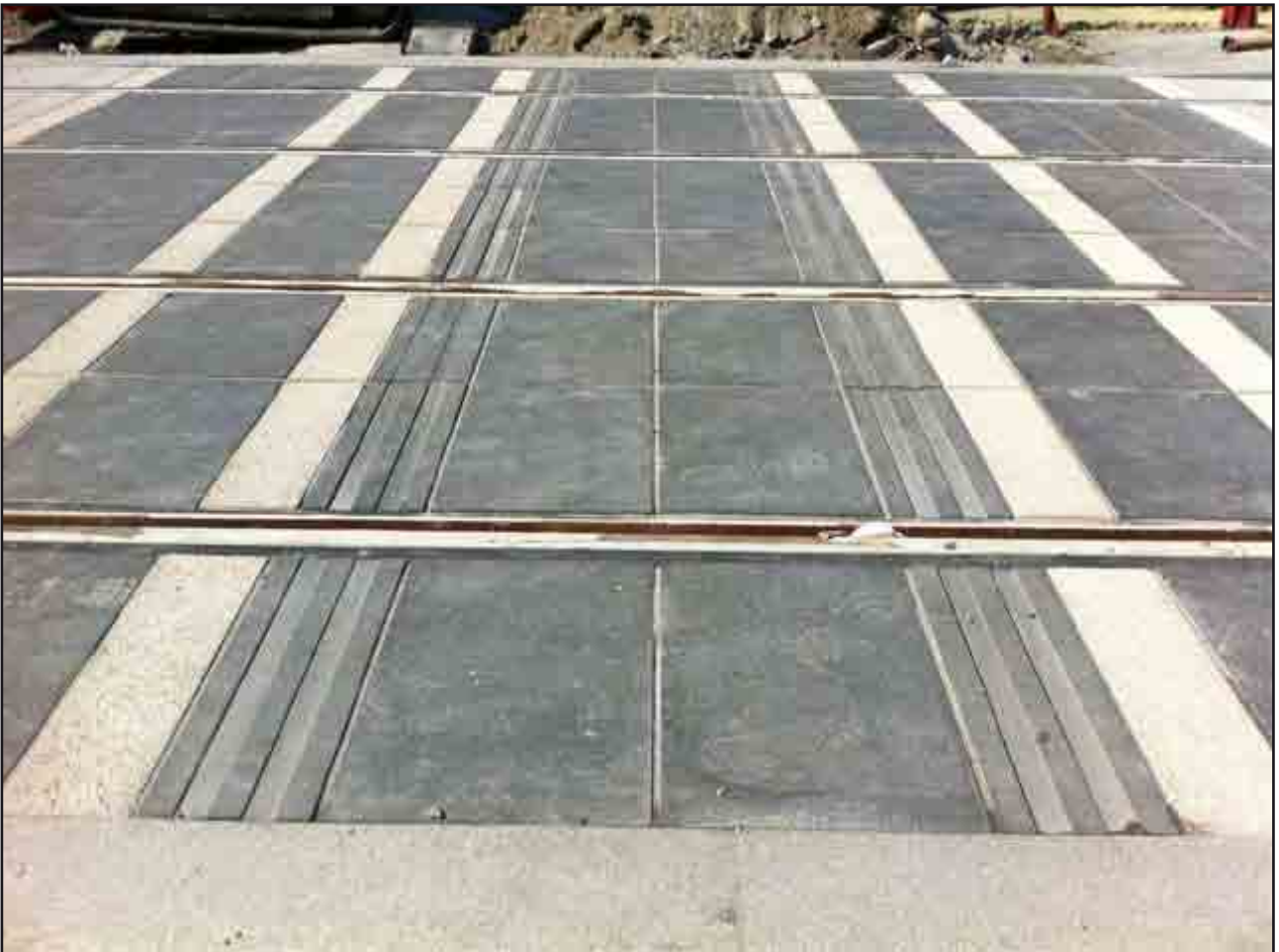
Un dispositif de marquage visuel et tactile a été adopté grâce à des essais auprès d'usagers pour faciliter le repérage de la traversée de la plate-forme du tramway (déploiement prévu pour l'extension de la ligne T3).
